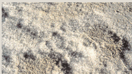
Efflorescenze saline su intonaco.
