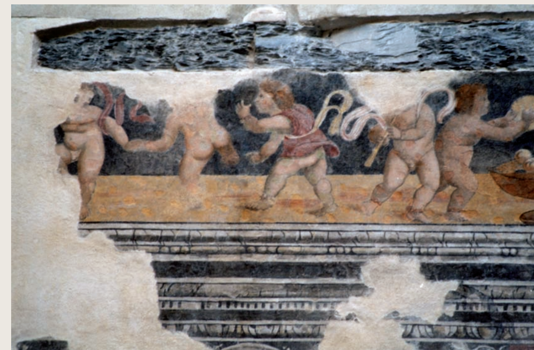
Genova, Piazza Embriaci, particolare di lacuna in un fregio decorato risolta con una integrazione a «tinta neutra».
