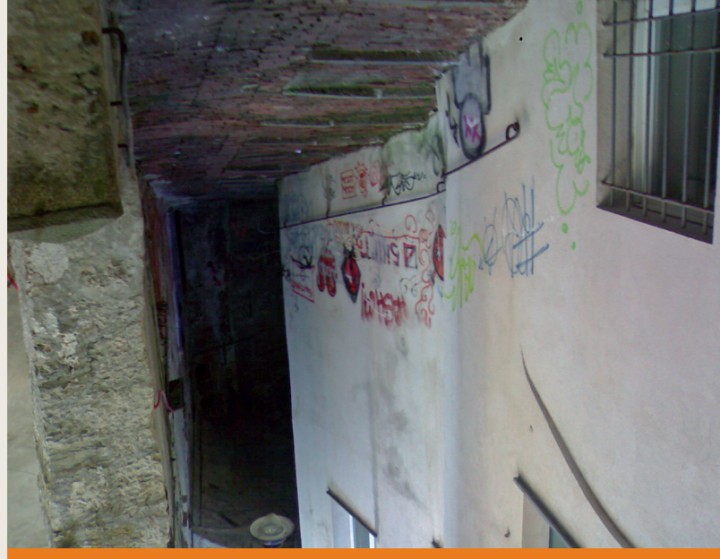
Presenza, in alcuni casi massiccia, di scritte vandaliche sui muri della città. Il fenomeno non risparmia gli edifici monumentali.
